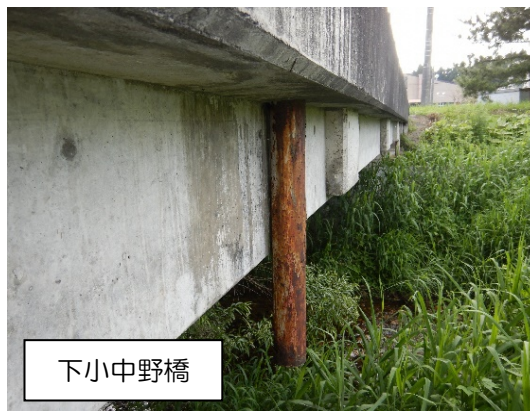
写真 12 排水管の腐食
