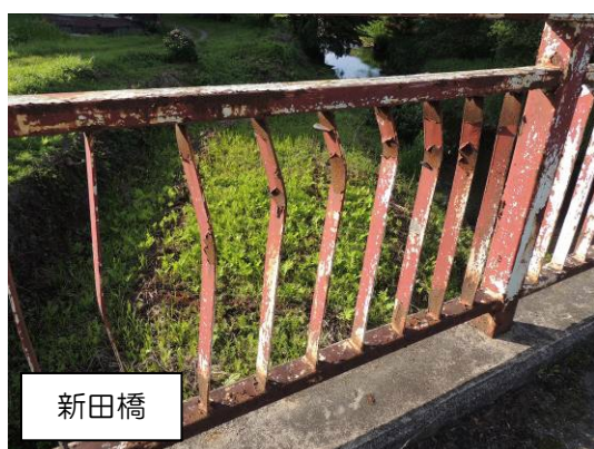
写真 9 防護柵の変形・腐食
