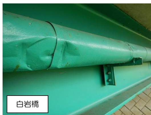
写真 10 添架物の変形
