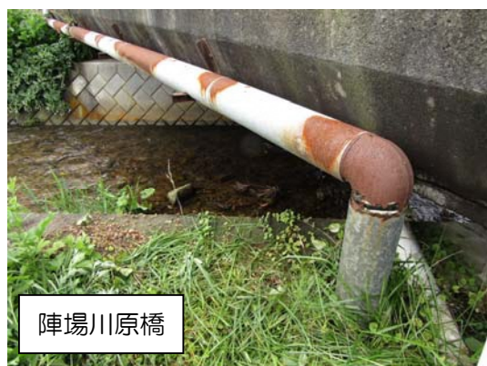
写真-3 添架管の腐食
