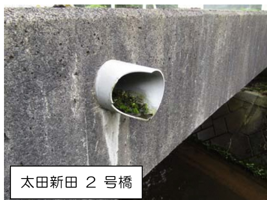
写真-1 排水管の破損
