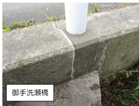
写真-4 地覆のひび割れ
