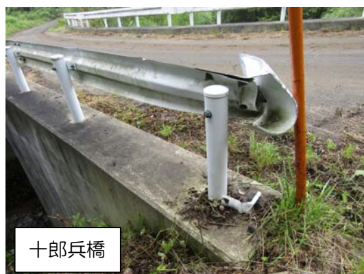
写真-2 防護柵の変形
