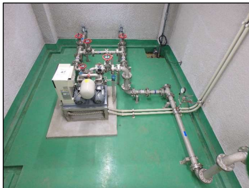
目ノ越配水場 加圧ポンプ
