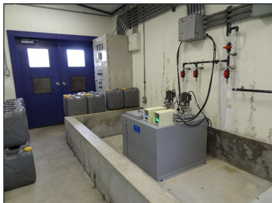
新田浄水場 滅菌設備
