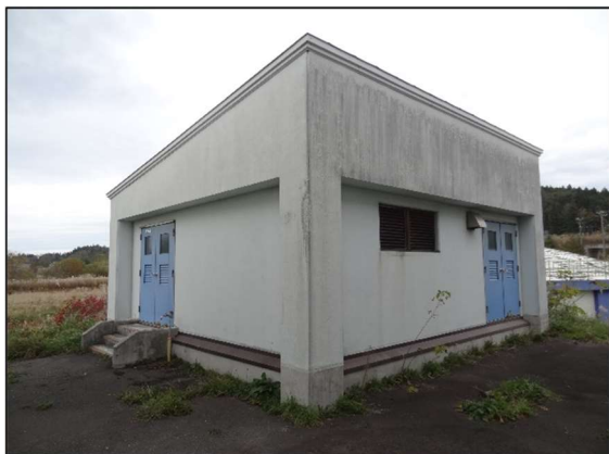
新田浄水場 滅菌施設
