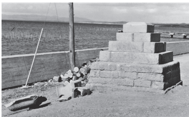
【写真③常夜燈の崩落】 撮影：1968（昭和43）年5月 町の文化財も被害を受けました。地震の揺れで常夜燈の灯籠部分が落ち、笠が破損。灯籠は積み直されましたが、現在も笠の一部は欠けたままになっています。
