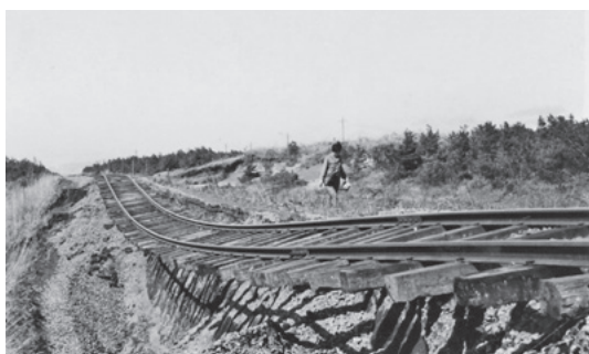
【写真②大湊線の被害】 撮影：1968（昭和43）年5月 地震の被害は国鉄・大湊線にも。有戸地区の路盤が崩れ、線路が浮いている状態になっています。
