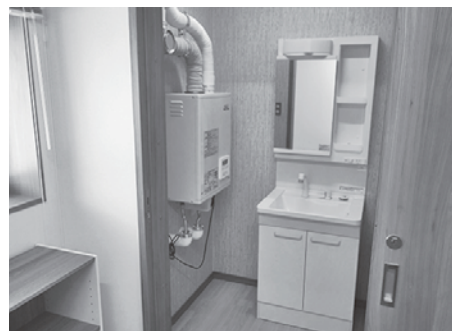
給湯器・洗面台
