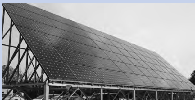
健康増進センターに設置された大型太陽光パネル
